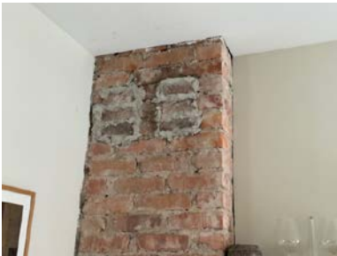
Ventil i luftepipe er tettet/murt igjen.
