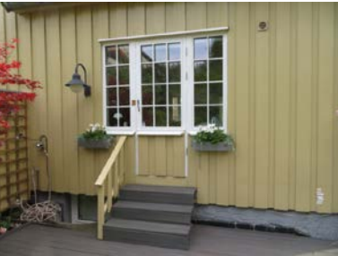
Manglende rekkverk på en side av trappen
