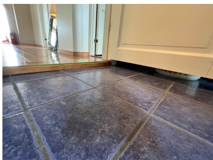
Det er ikke mulig å se om det er laget vanntett oppkant under døren.
