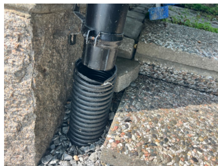
Rør for takvann ikke tilfredsstillende tilkoblet rør i grunn.
