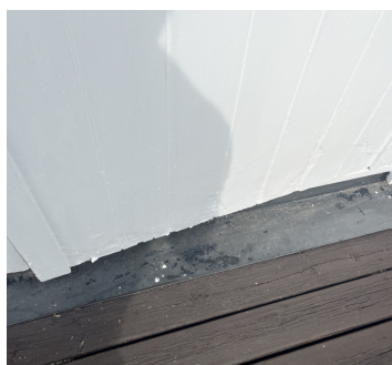
Balkongdør er noe skadet av fukt.
