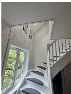
Mangler håndlist, krav da ny etasje ble oppført.
