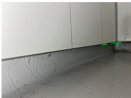
Ikke fuget i nedkant på veggplater i våtzone.
