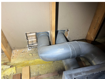
Uisolerte inntak og avkast kanaler.
