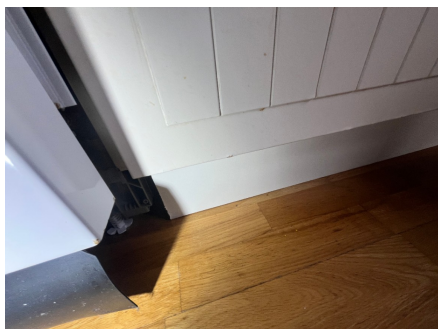
Fuktsvelling på skapdør.
