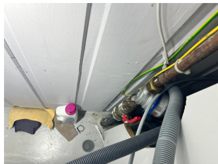
Stoppekran og vannmåler
