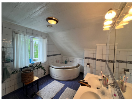
Vindu i våtzone og himling uten våtroms behandling.
