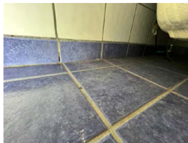
Sprekk i elastisk fuge under badekar og løs vertikal fuge.
