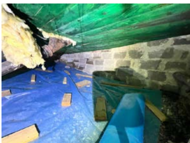
Soillrør og jernsluk fra toalettrom.
