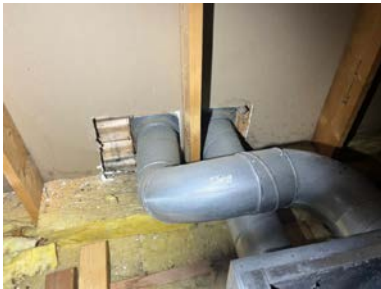
Uisolerte inntak og avkast kanaler.
