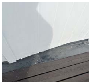
Balkongdør er noe skadet av fukt.
