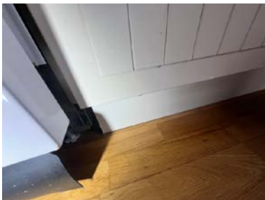
Fuktsvelling på skapdør.
