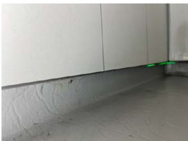
Ikke fuget i nedkant på veggplater i våtsone.
