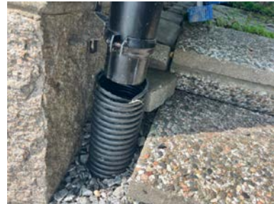
Rør for takvann ikke tilfredsstillende tilkoblet rør i grunn.
