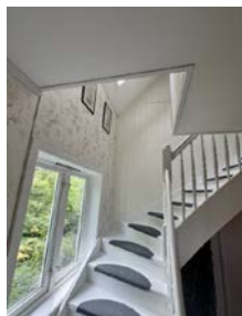
Mangler håndlist, krav da ny etasje ble oppført.
