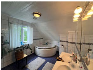
Vindu i våtsone og himling uten våtroms behandling.
