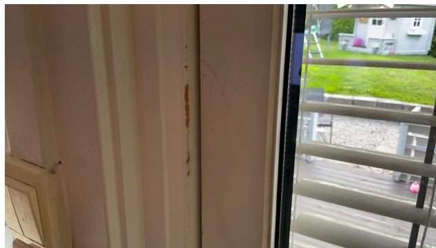
Eksempel på at terrassedør mangler noe maling.
