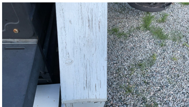
Eksempel på avflassing av maling på toppbord.
