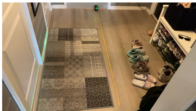
Meterstokk viser hvor avvik er registrert.
