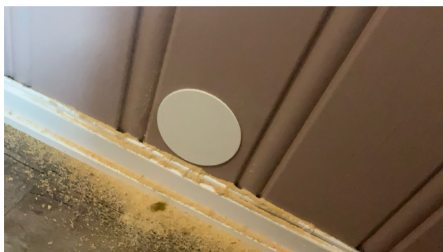
Hull forsvarlig plombert.
