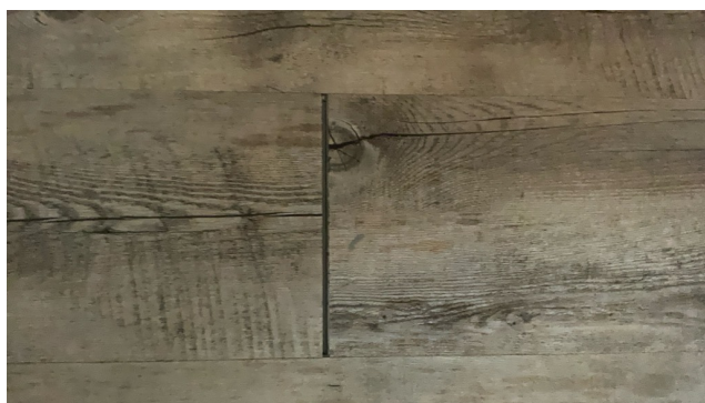
Eksempel på at enkelte endeskjøter går ifra hverandre.
