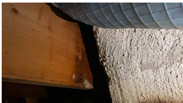
Eksempel på fuktskjolde på loft.
