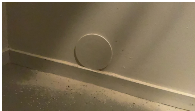
Hull forsvarlig plombert.
