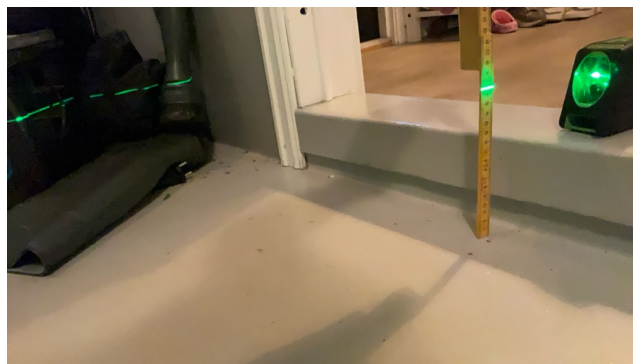
Det er målt 16,8cm på gulv ved terskel.
