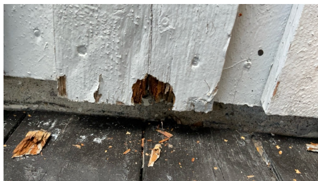
Eksempel på råde i bordkledning.
