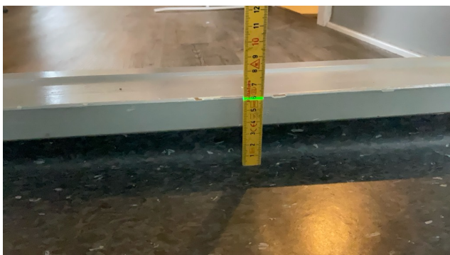
Det er målt 6cm på gulv ved terskel.
