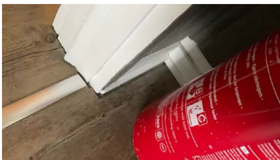
Eksempel på at list ikke dekker glippe mellom vegg og gulv.
