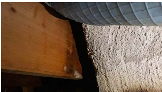
Eksempel på fuktskjolde på loft.
