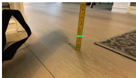
Det er målt 4,9cm på gulv ca 2m ifra gulv ved vaskeromsdør.
