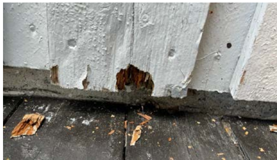
Eksempel på råte i bordkledning.
