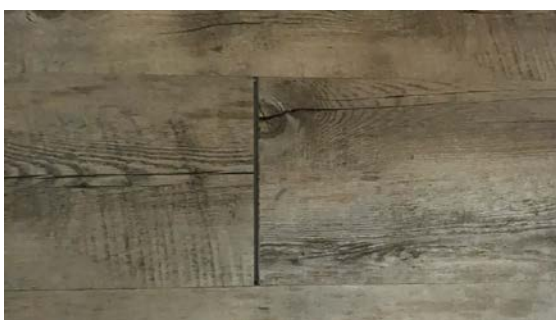
Eksempel på at enkelte endeskjøter går fra hverandre.
