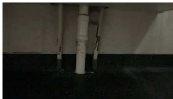
Vannledninger av kobber.
