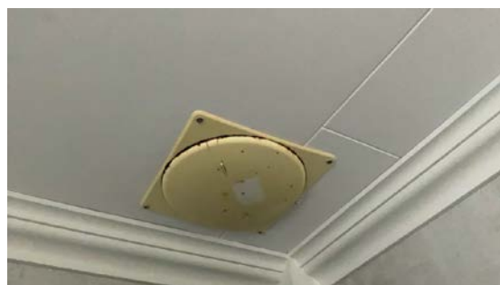
Ventil var ikke mulig å skru opp på befaring.
