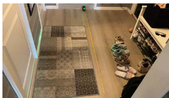
Meterstokk viser hvor avvik er registrert.
