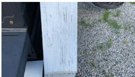
Eksempel på avflassing av maling på toppbord.
