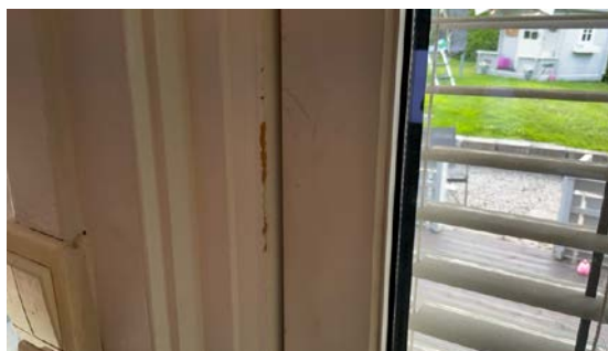
Eksempel på at terrassedør mangler noe maling.
