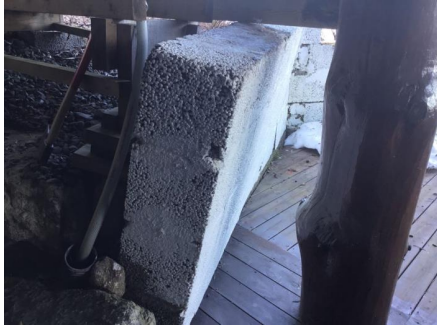
Store skjevheter i mur.
