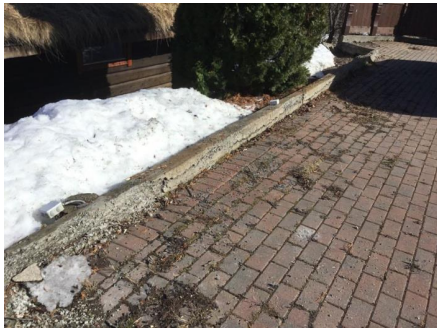
Skader og forvitring på støpt mur.
