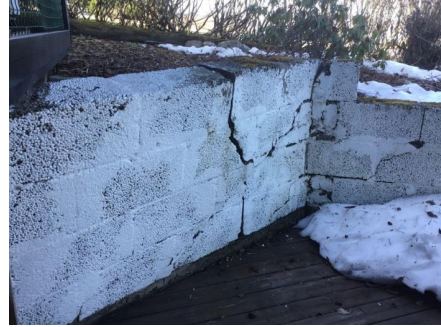
Store sprekker i mur
