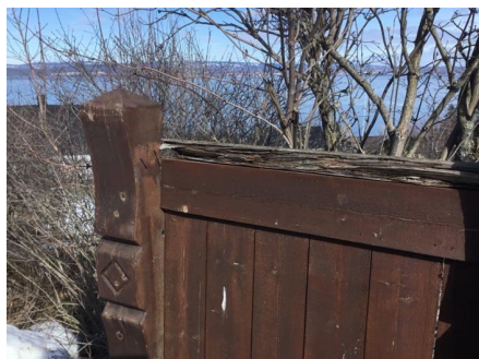
Råteskade på gjerde.
