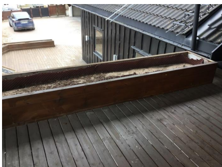
Manglende rekkverk på veranda.
