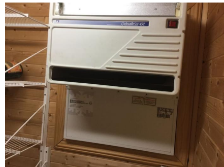
Kjøleaggregat er defekt.
