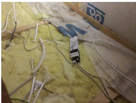
Ufagmessig utførelse på ledningsnett til spotter.
