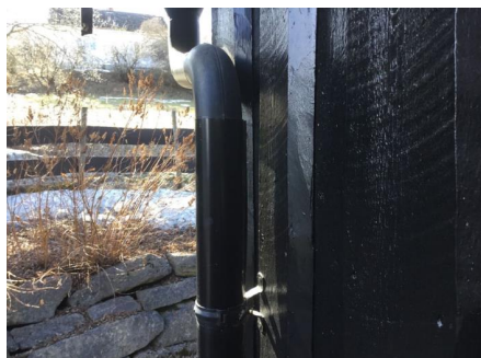
Frostspreng på takrennedløp.
