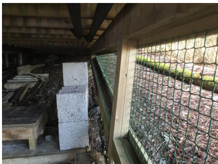
Skjevheter i fundamentering
