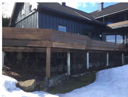
Konstruksjonen har sannsynligvis utilstrekkelig bæreevne. Skjevheter registrert.
