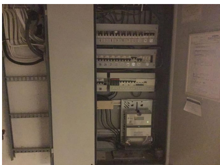
Sikringskap plassert i kjeller.
