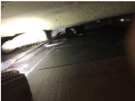
Sluk kontrollert med speil grunner plassering av dusjkabinett.
