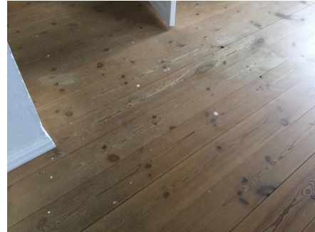
Malingssøl på overflater flere steder.
