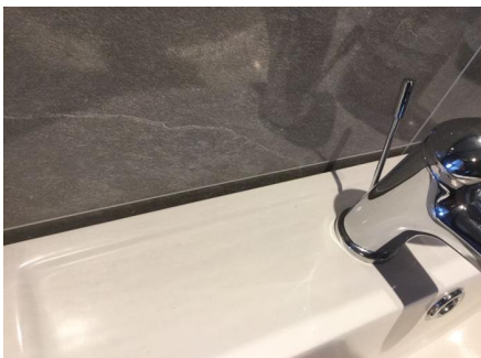
Anbefaler fuge mellom servant og vegg.
