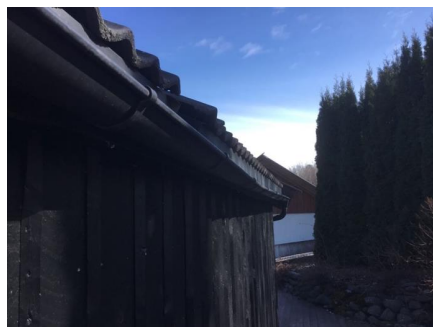
Takrenner har blitt bøyd, sannsynligvis som følge av snøras.
