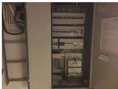
Sikringsskap plassert i kjeller.
