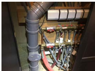
Sentral/fordeling plassert i kjeller.
