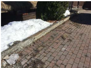
Skader og forvitring på støpt mur.
