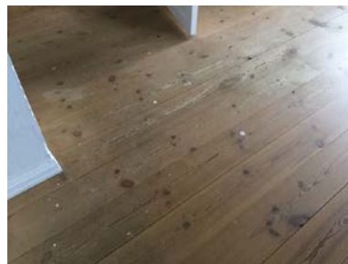
Malingssøl på overflater flere steder.
