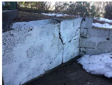
Store sprekker i mur
