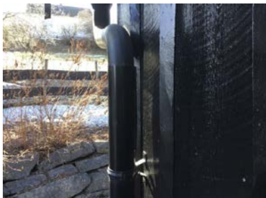
Frostspreng på takrennedeløp.
