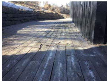
Nedsenk og slitasje på overflater.
