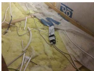
Ufagmessig utførelse på ledningsnett til spotter.
