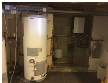
Tank for oppvarming plassert i kjeller.
