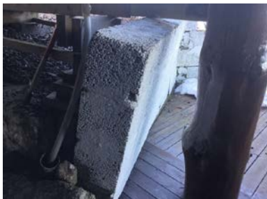
Store skjevheter i mur.
