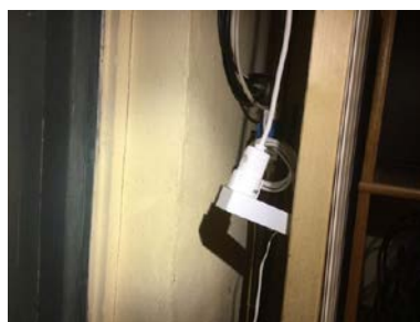
Fast installasjon skal ha fast tilkobling. Skjøteledning er benyttet på fast instalasjon.
