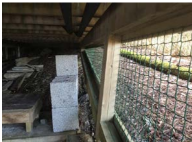
Skjevheter i fundamentering
