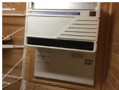
Kjøleaggregat er defekt.
