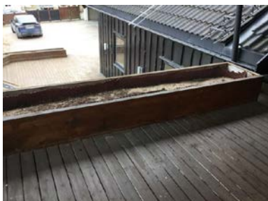
Manglende rekkverk på veranda.
