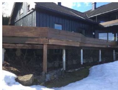
Konstruksjonen har sannsynligvis utilstrekkelig bæreevne. Skjevheter registrert.
