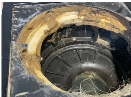
Hull i forhøyningsring i sluk.
