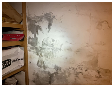
Saltutslag på vegg.
