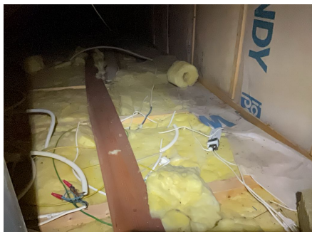
Ufagmessig utførelse på ledningsnett til spotter.
