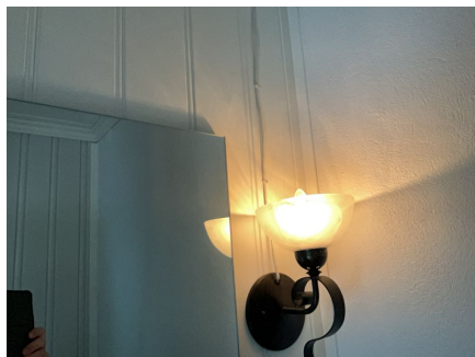
Ujordet ledning er benyttet i fast installasjon
