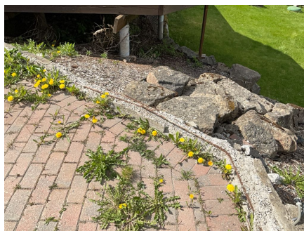
Skader og forvitring på støpt mur.
