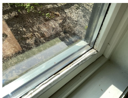
Kondensmerker på enkelte vinduer.
