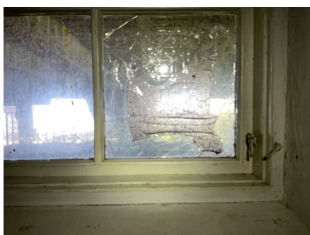
Knust vindu i teknisk rom.
