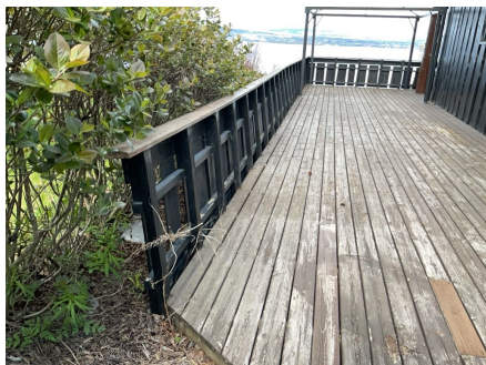
Skjevheter i rekkverk og slitasje på overflater.
