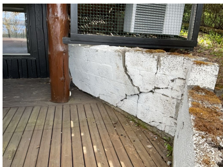
Store sprekker i mur
