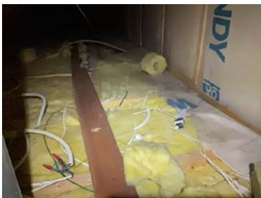
Ufagmessig utførelse på ledningsnett til spotter.
