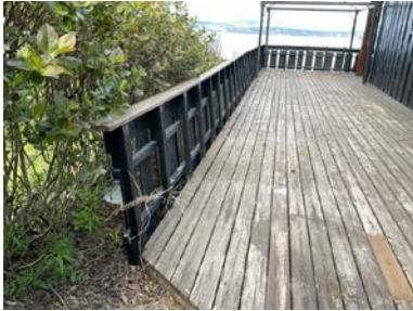
Skjevheter i rekkverk og slitasje på overflater.
