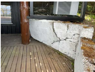
Store sprekker i mur
