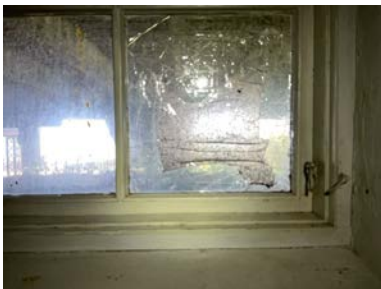
Knust vindu i teknisk rom.
