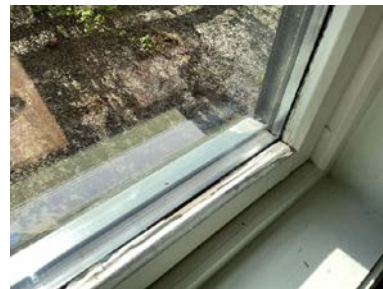
Kondensmerker på enkelte vinduer.
