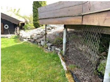
Dårlig understøtting. Konstruksjonen har sannsynligvis utilstrekkelig bæreevne. Råteskader på rekkverk.
