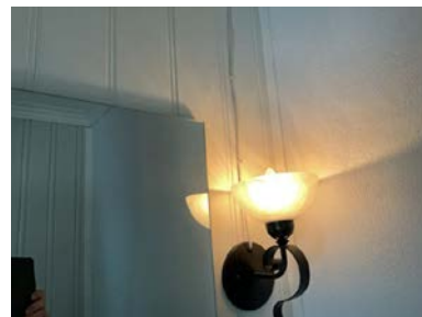
Ujordet ledning er benyttet i fast installasjon
