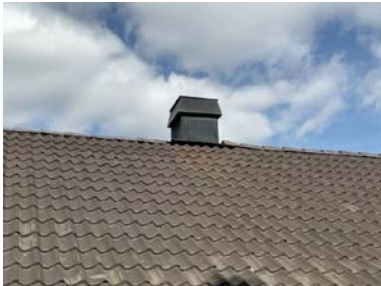
Glippe på beslag rundt pipe.
