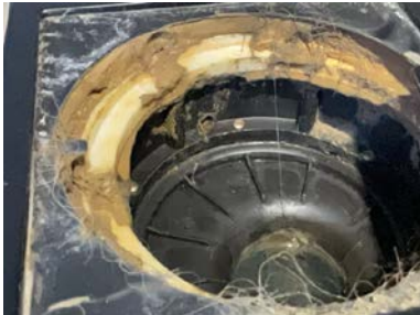
Hull i forhøyningsring i sluk.
