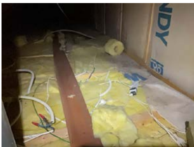
Ufagmessig utførelse på ledningsnett til spotter.
