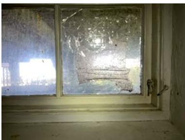
Knust vindu i teknisk rom.
