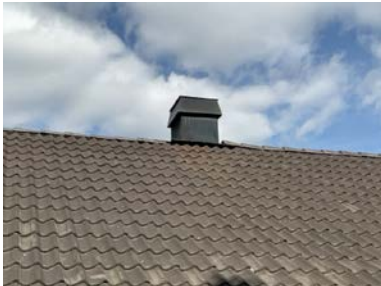
Glippe på beslag rundt pipe.
