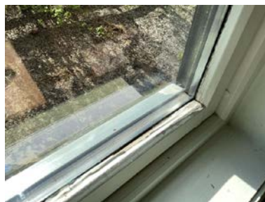
Kondensmerker på enkelte vinduer.
