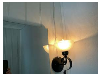
Ujordet ledning er benyttet i fast installasjon
