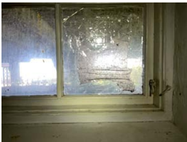
Knust vindu i teknisk rom.
