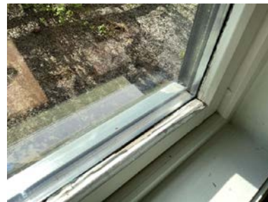
Kondensmerker på enkelte vinduer.
