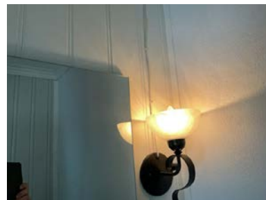
Ujordet ledning er benyttet i fast installasjon
