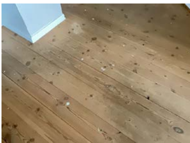
Malingssøl på overflater flere steder.
