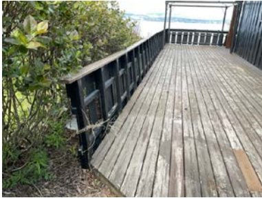
Skjevheter i rekkverk og slitasje på overflater.
