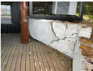
Store sprekker i mur
