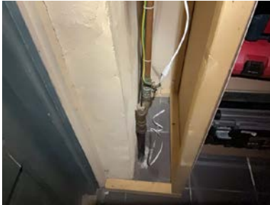
Stoppekran plassert i kjeller.
