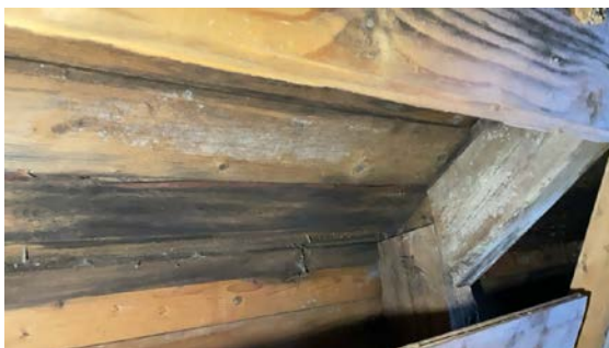
Undertak er synlig fra hull i himling loftsetasje.
