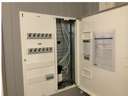
El-anlegg med automatsikringer. I hovedsak skjult ledningsnett. Sikringsskapet er plassert i bod/teknisk rom.
