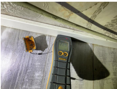
Fuktmåling i fotlist kjøkken
