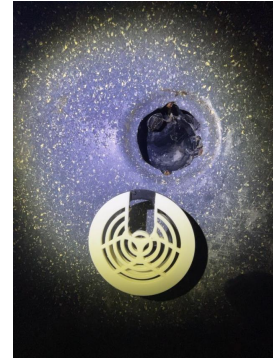
Utett rundt sluk- klemringens skruer er rustet av.
