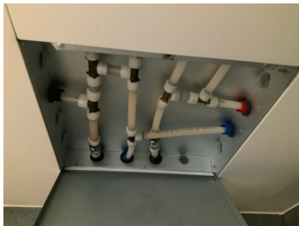
Samleskap med rørkurser og stoppekraner i leilighet
