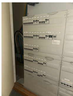
Sikringsskap med automatsikringer.
