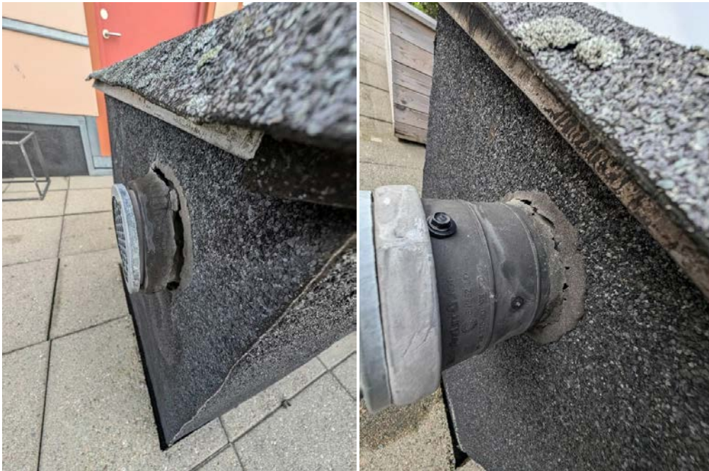
Bildene over viser gjennomføringer hvor fug har sprukket.
