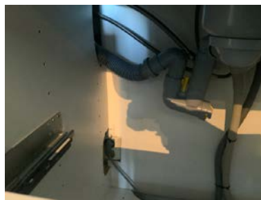
Rørpropplegg på kjøkken i leilighet
