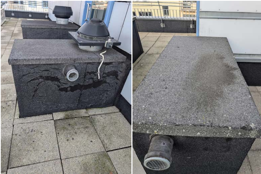
Bildene over viser solskadet membran og topp på gjennomføring med mot fall.
