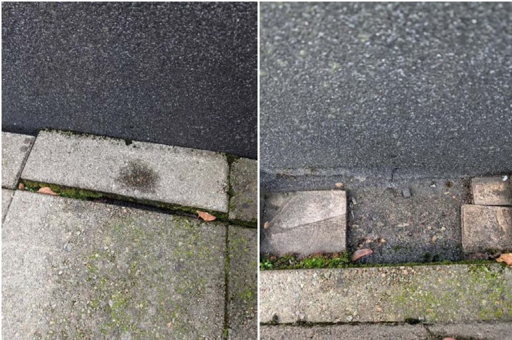
Bildene over viser heller og underlag. Det gror mose mellom hellene. Det ble også observert organisk materiale mellom og rundt hellene som kan hindre avrenning mot sluk.
