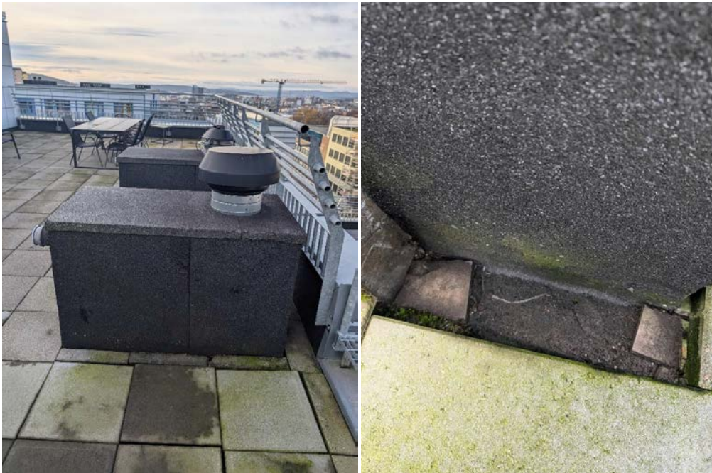
Bildene over viser gjennomføring. Det ble ikke observert svanker eller avvik på membranen.
