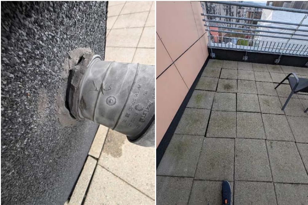
Bildene over viser sprukket fug i gjennomføring og ujevne heller.
