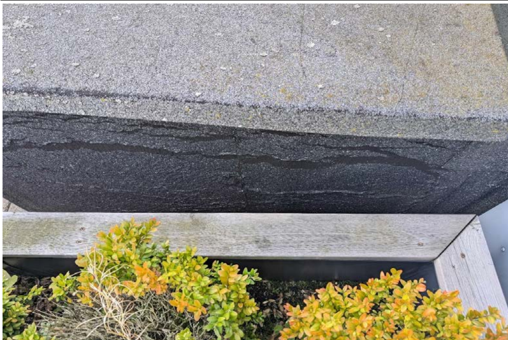
Bilde over viser solskadet membran.
