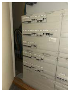
Sikringsskap med automatsikringer.
