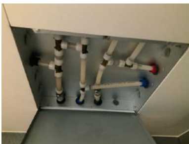
Samleskap med rørkurser og stoppekraner i leilighet
