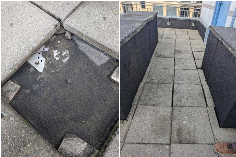
Bildene over sluk og heller. Øverst på bilde til venstre, har XPS platene som fungerer som hellene ligger på begynt å gå i oppløsning. Bilde til høyre viser svært ujevne heller.
