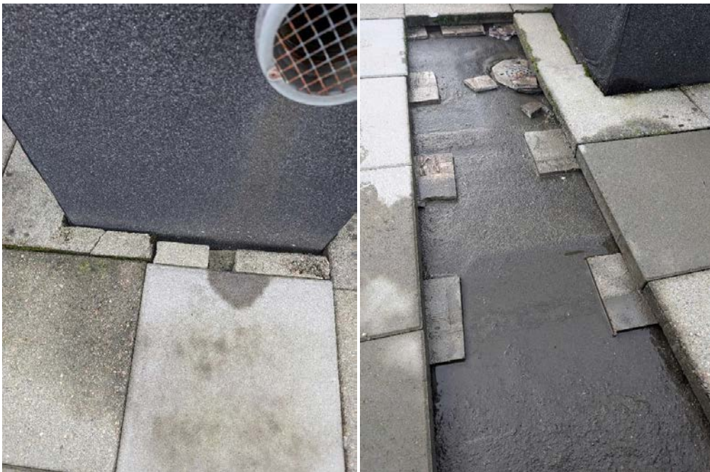
Bildene til venstre viser sprukket helle. Bilde til høyre viser en ansamling av vann som ikke renner mot sluk. Det ble observert lokale ujevnheter i fallisolasjonen.
