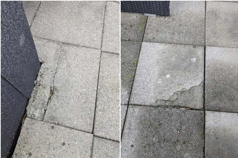
Bildene over viser sprukket og skadet heller.
