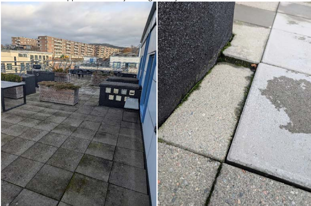
Bildene over gir et overblikk av takterrasse i 7 etasje. Det ble observert mose på hellene. På bilde til høyre ser man en helle som ikke ligger jevnt. Det antas at XPS platen ikke ligger slik den skal eller har gått i oppløsning.
