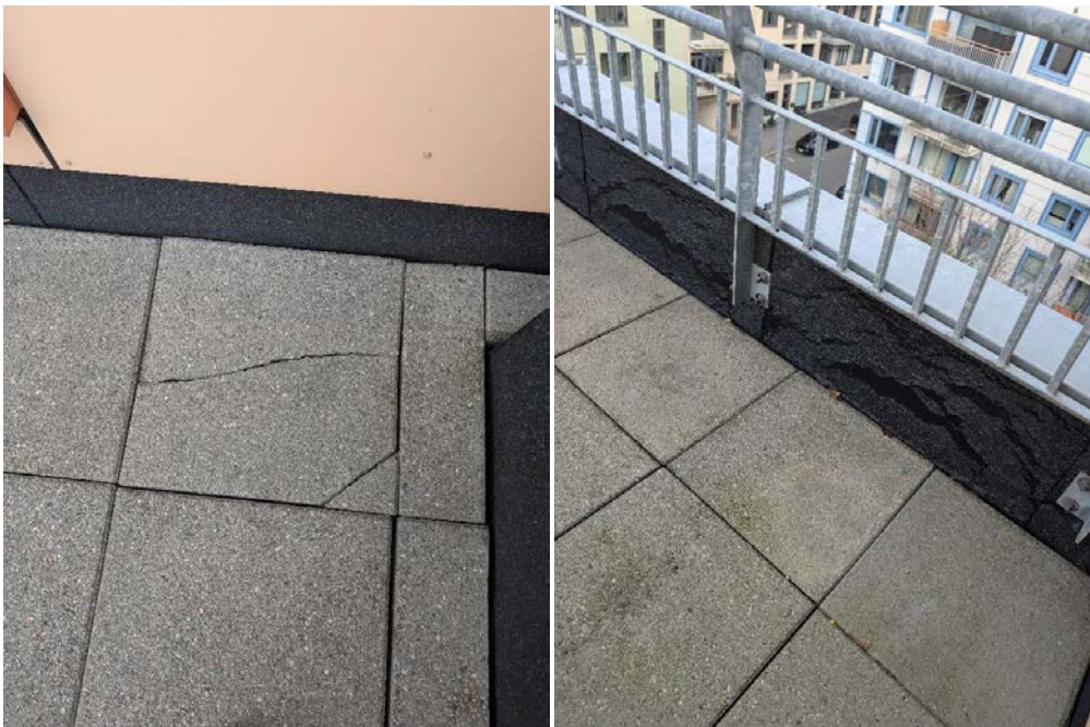
Bildene over viser sprukket helle og solskadet membran.
