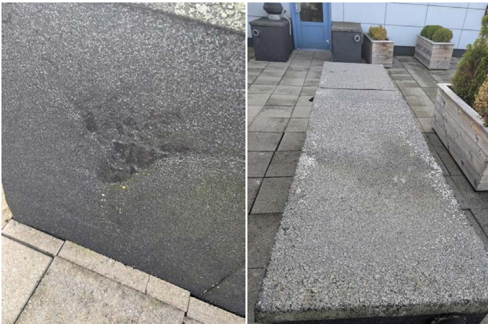
Bildene over viser luftkasse. Membranen har seget noe og toppen av kassa har mot fall så vann blir liggende oppå kassa.
