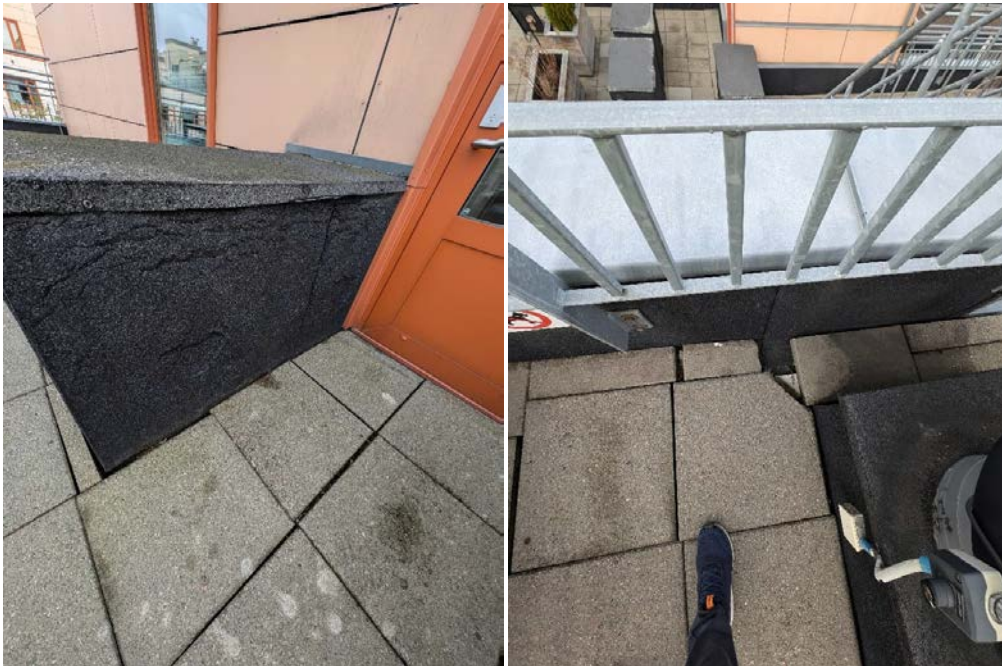
Bildene over viser solskadet membran og sprukket helle.
