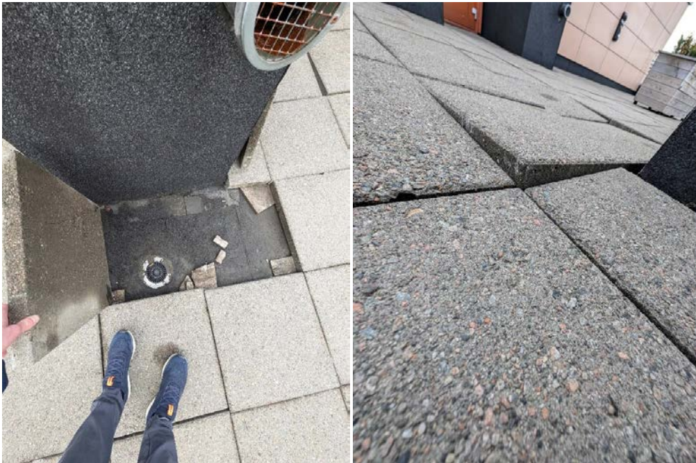
Bildene over viser sluk og ujevne heller.
