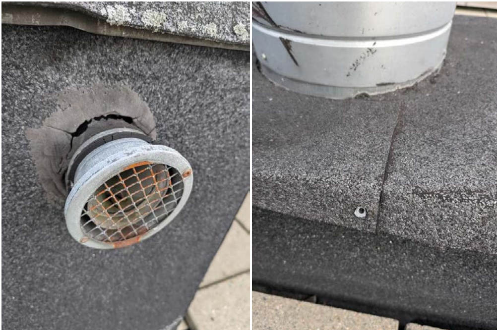
Bildene over viser gjennomføring hvor fug har sprukket opp. Det mangler også innfesting i lufttekassa.
