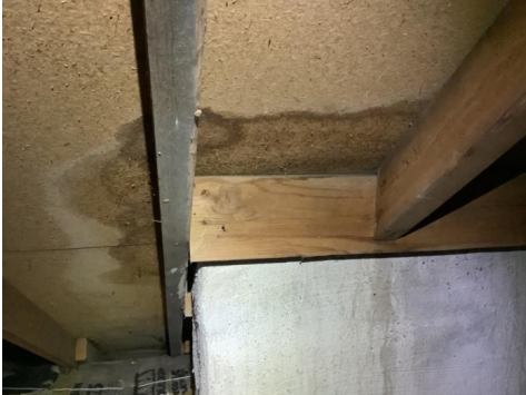
Fuktmerker på undertak nær pipe.
