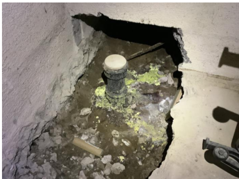
Avløpsrør fra vaskekjeller er frakoblet og plugget.
