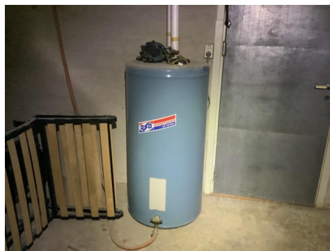
Eldre varmtvannsbereider åpen plassert i grovkjellerrom (vaskekjeller)
