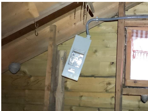
Inntaksboks på gavlvegg på loft er løs.
