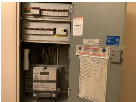
Sikringsskap med automatsikringer i gang
