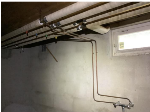
Vannrør i kjeller.
