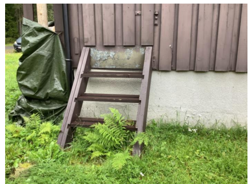
Provisorisk bratt trapp uten rekkverk/sikring til bod inngang.
