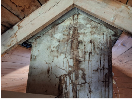
Sprekkdannelse i pipe. Gamle fuktmerker
