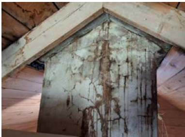
Sprekkdannelse i pipe. Gamle fuktmerker
