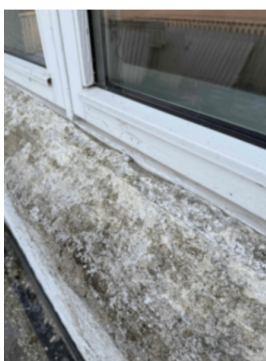
Bildet viser utett overgang mellom vindu og utvendig murpuss.
