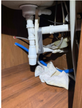
Bildet viser lekkasje fra avløpsrør.
