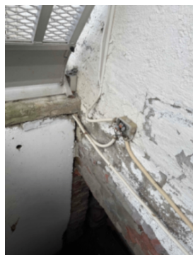
Bildet viser ødelagt utvendig koblingsboks.
