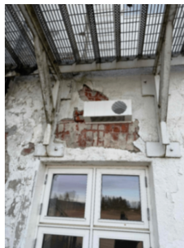
Bildet viser manglende murpuss.
