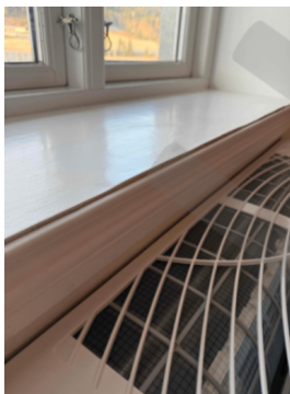
Bildet viser svelling på vindusforing
