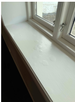
Bildet viser svelling på vindusforing.
