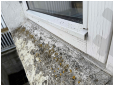
Bildet viser værslitt vinduskarm.
