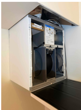
Bildet viser ventilasjonsanlegget.
