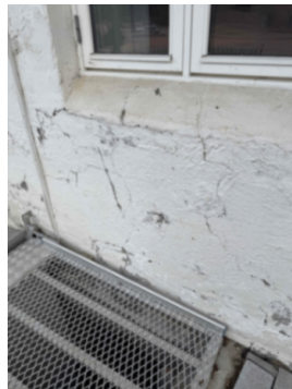
Bildet viser sprekker i murte/pussede fasader.
