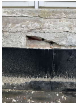
Bildet viser sprekker i murte/pussede fasader.
