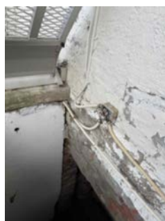
Bildet viser ødelagt utendig koblingsboks.
