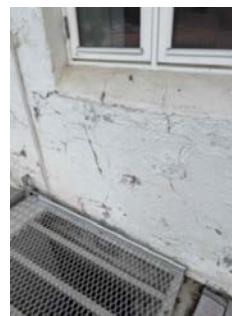
Bildet viser sprekker i murte/pussede fasader.
