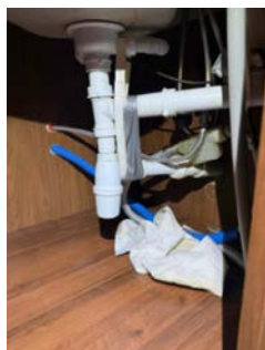
Bildet viser lekkasje fra avløpsrør.
