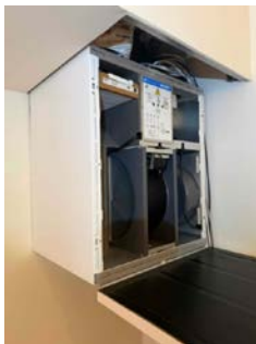
Bildet viser ventilasjonsanlegget.
