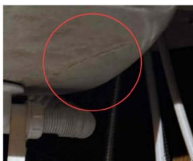
Bildet viser sprekk i oppvaskkum.
