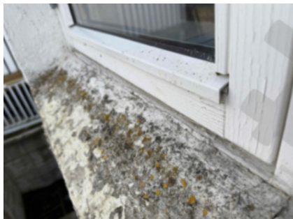
Bildet viser værslitt vinduskarm.
