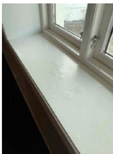
Bildet viser svelling på vindusforing.
