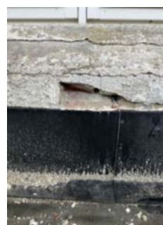
Bildet viser sprekker i murte/pussede fasader.
