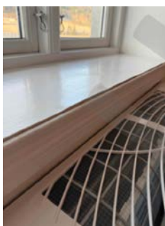
Bildet viser svelling på vindusforing
