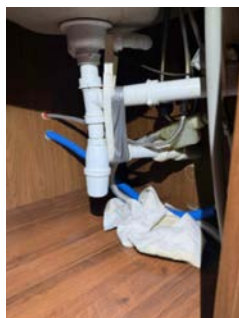
Bildet viser lekkasje fra avløpsrør.
