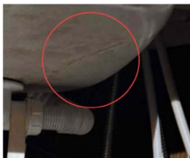
Bildet viser sprekk i oppvaskkum.
