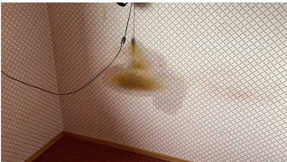
Misfarging på overflater.
