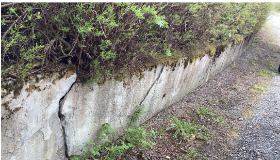
Større sprekker i støttemur.
