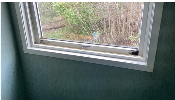
Vinduer bærer preg av slitasje.
