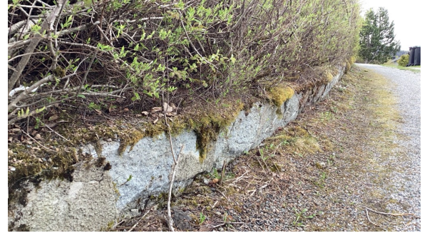
Skjevheter i mur.
