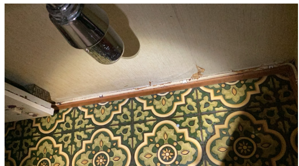
Drypper fra vannlås på toalettrom i 1. etasje.
