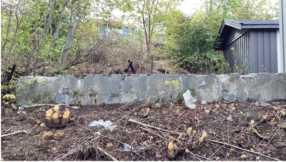
Sprekker i mur.
