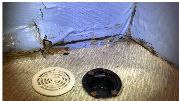
Hull i vegg i dusjsone.
