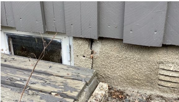
Sprekk i mur.
