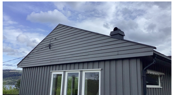
Deler av kledning bærer preg av slitasje og er modent for utskifting.
