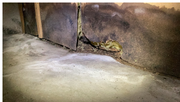
Råte observert i vegg bak dusjsone.
