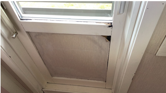
Skade på terrassedør.
