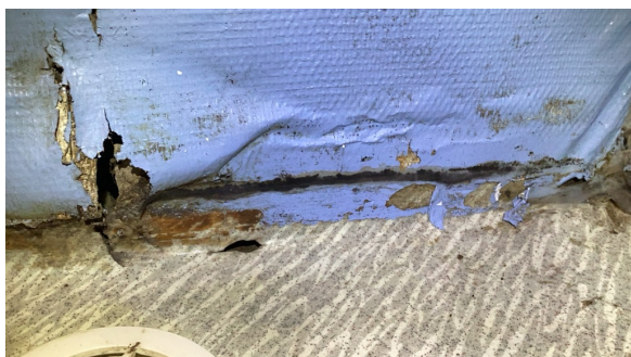
Hull i veggen i dusjsonen.
