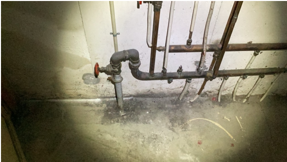
Stoppekran i underetasje.
