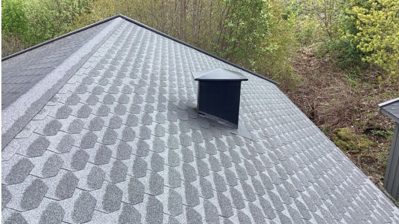
Shingel er ikke lagt som anbefalt inn mot luftelyre.
