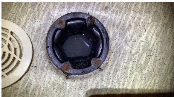
Sprekk i membran rundt sluk.
