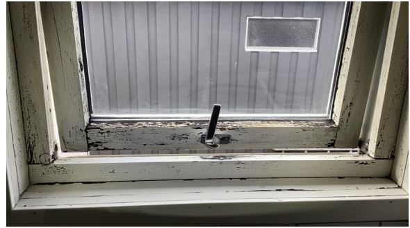
Vinduer bærer preg av slitasje.
