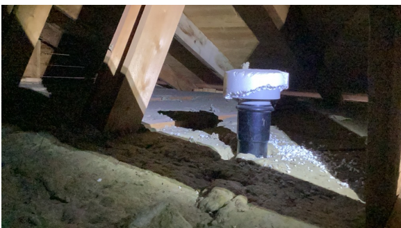
Lufting fra avløp er ikke korrekt utført, skal føres over tak.
