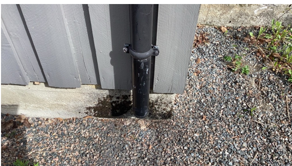
Taknedløp mangler utkast og tilfredsstillende bortledning av takvann flere steder.
