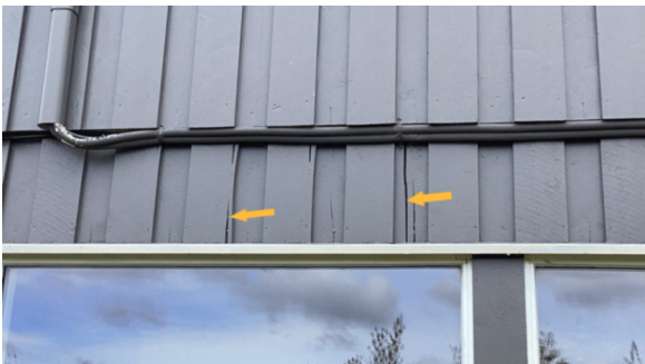
Sprukne panelbord rundt om.
