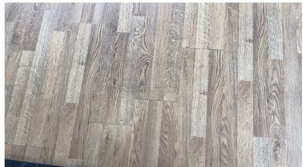
Gulv er feilmontert enkelte steder, endeskjøter er ikke tilstrekkelig forskjøvet.
