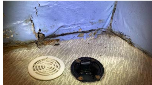
Hull i vegg i dusjsone.
