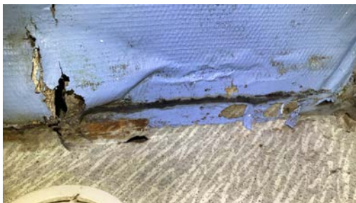
Hull i vegg i dusjsonen.
