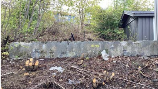
Sprekker i mur.
