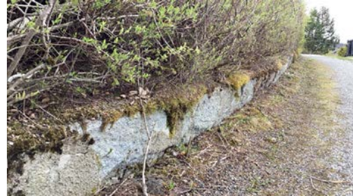
Skjevheter i mur.
