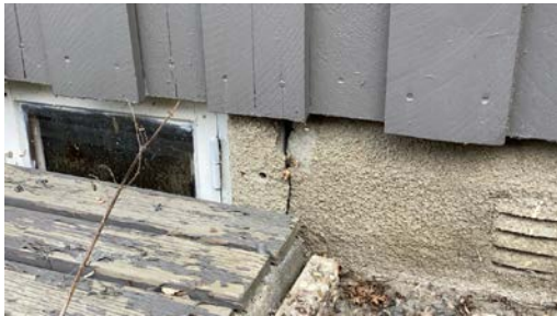
Sprekk i mur.
