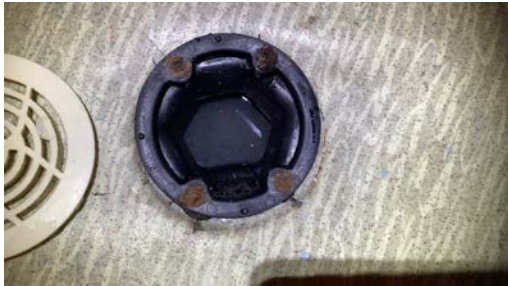
Sprekk i membran rundt sluk.
