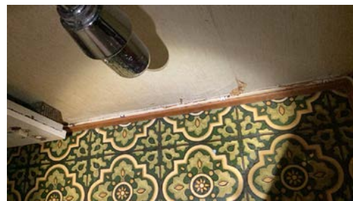
Drypper fra vannlås på toalettrom i 1. etasje.
