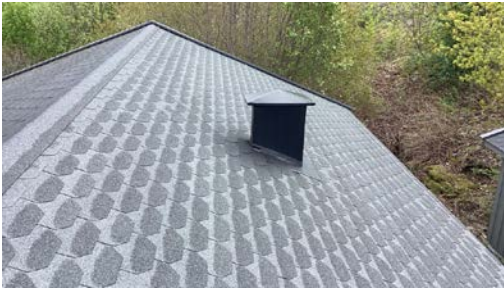
Shingel er ikke lagt som anbefalt inn mot luftelyre.
