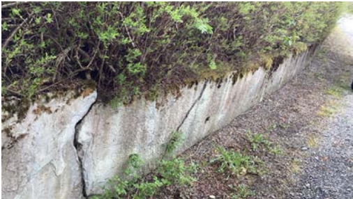
Større sprekker i støttemur.
