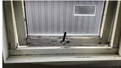
Vinduer bærer preg av slitasje.
