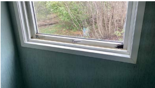
Vinduer bærer preg av slitasje.
