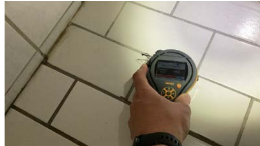
Ved bruk av fuktindikator på utsatte steder registrerte jeg unormale verdier.
