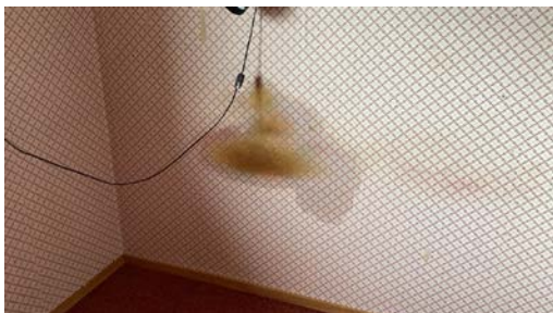
Misfarging på overflater.
