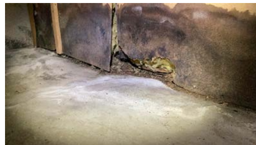
Råte observert i vegg bak dusjsone.
