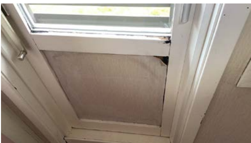
Skade på terrassedør.
