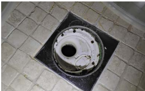
Sluk bad 1 etg
