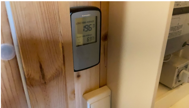
Digital måler montert i bygget
