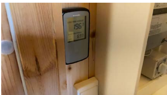
Digital måler montert i bygget
