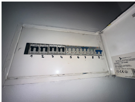
Sikringskap med automatsikringer.
