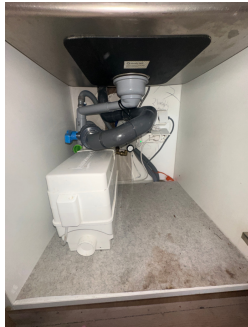
Røropplegg i kjøkkenbenk med Waterguard
