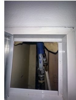
Stoppekraner plassert på soverom
