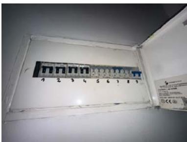
Sikringskap med automatsikringer.
