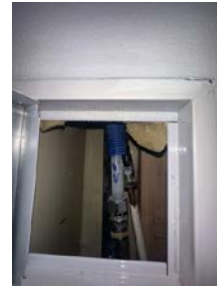
Stoppekraner plassert på soverom
