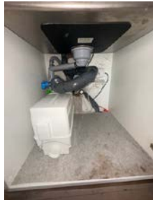
Rørpropplegg i kjøkkenbenk med Waterguard
