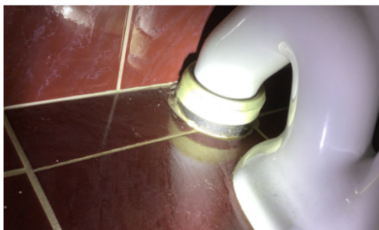
Ingen synlig membran rundt røroppstikk i gulv
