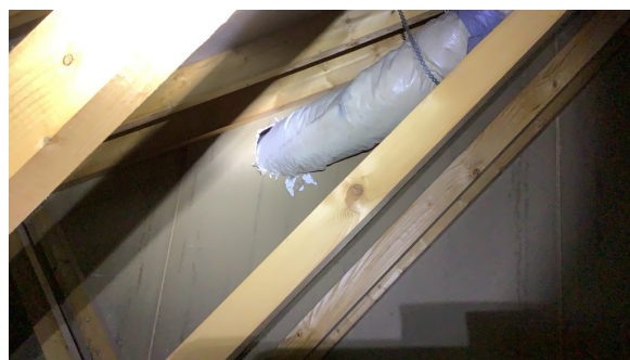
Ventilasjonsrør er ført gjennom brannvegg.
