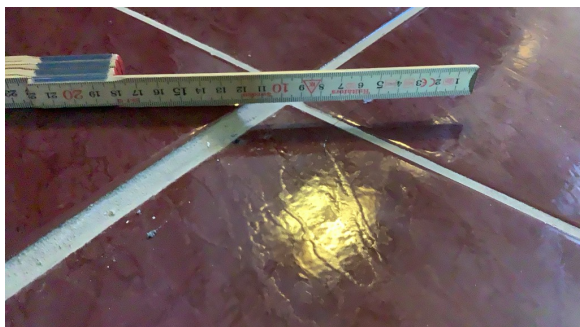
Det er lagt en flis ovenpå en annen flis i hjørnet, ukjent årsak.
