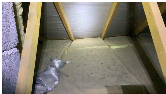
Isolasjon dekker delvis lufting fra raft
