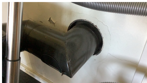
Overflate er skadet etter røykrør er for nærme brannmur
