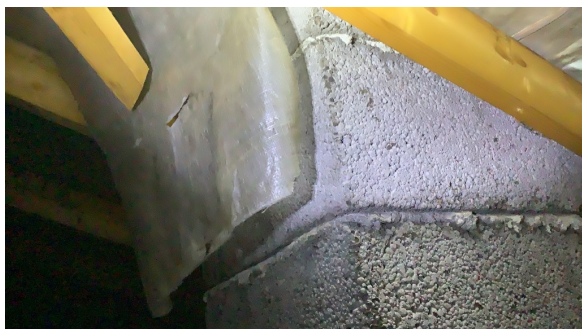
Utett undertak rundt gjennomføringer.
