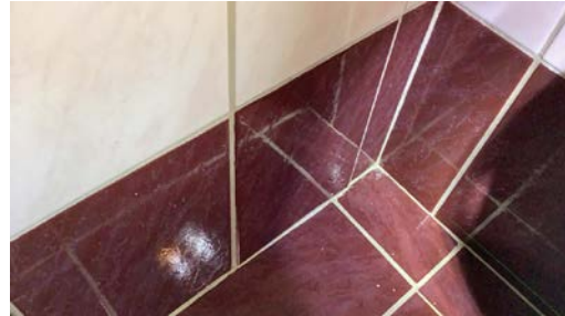
Sprang mellom flis i dusjsonen.
