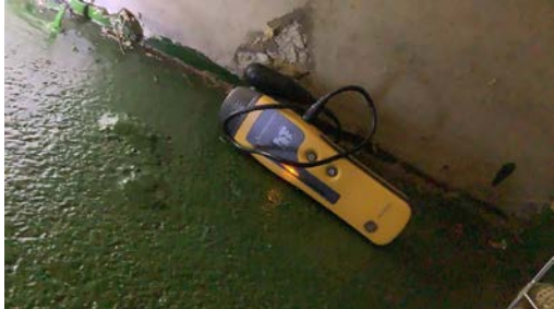
Multimur. Gips/skum i påforet betongvegg. Det ble registrert forhøyede verdier i treverk i bunnsvill på elementer.
