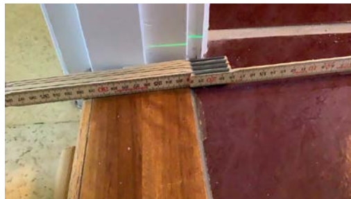
Det er ikke membran i oppkant ved dørterskel.
