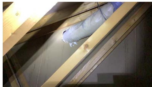
Ventilasjonsrør er ført gjennom brannvegg.
