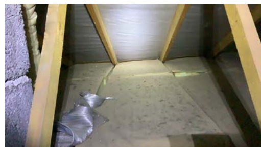
Isolasjon dekker delvis lufting fra raft
