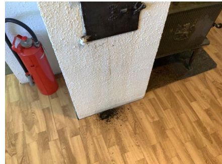
Bildet viser at det mangler ildfast plate på gulv under sotluke.
