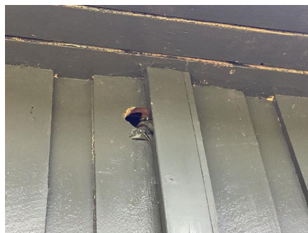
Bildet viser hull i bordkledning.
