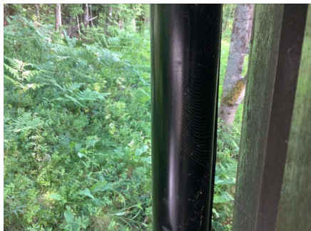
Bildet viser frostsprengt nedløpsrør.
