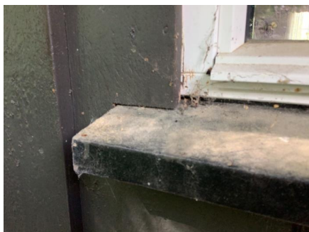
Bildet viser at omramming rundt vindu er ført helt ned til vannbrett.
