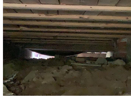
Bildet viser løsnet stubbeloftsplate.
