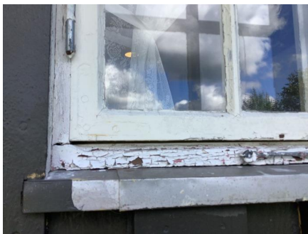
Bildet viser eksempel på værslitt vindu.
