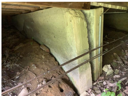
Bildet viser skjev ringmur.
