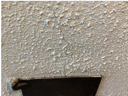
Bildet viser riss i pipe.
