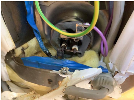
Bildet viser svimerker i elektrisk tilkobling.
