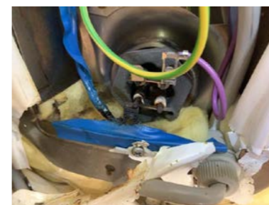
Bildet viser svimerker i elektrisk tilkobling.
