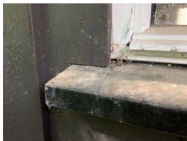
Bildet viser at omrømming rundt vindu er ført helt ned til vannbrett.
