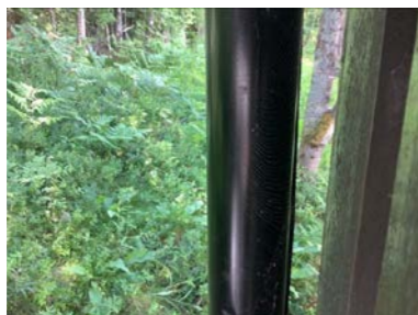
Bildet viser frostsprengt nedløpsrør.
