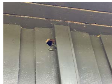
Bildet viser hull i bordkledning.
