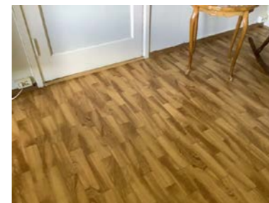
Bildet viser at det er jordet og ujordet stikkontakt på samme vegg.
