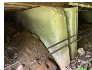
Bildet viser skjev ringmur.
