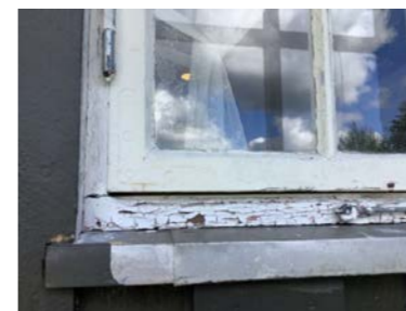
Bildet viser eksempel på værslitt vindu.
