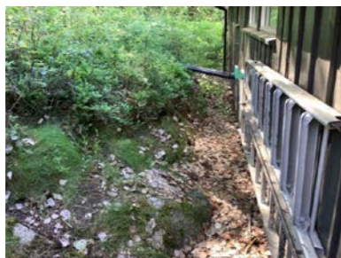
Bildet viser at det er fall mot bygning.
