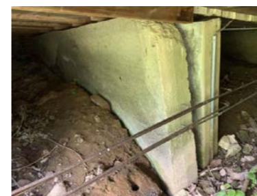
Bildet viser skjev ringmur.
