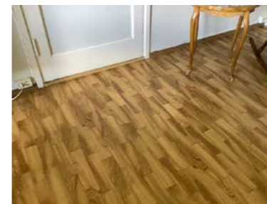
Bildet viser at det er jordet og ujordet stikkontakt på samme vegg.
