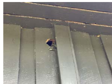
Bildet viser hull i bordkledning.
