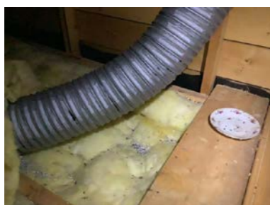
Bildet viser at mus har gnaget hull i ventilasjonsslange.
