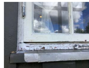
Bildet viser eksempel på værslitt vindu.
