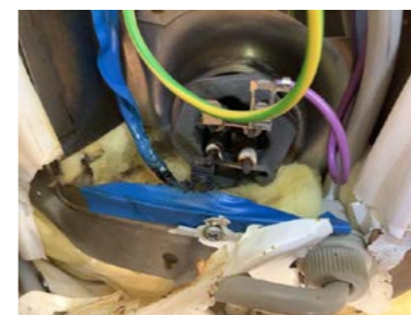
Bildet viser svimerker i elektrisk tilkobling.
