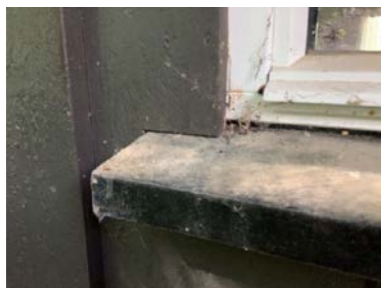
Bildet viser at omrømming rundt vindu er ført helt ned til vannbrett.
