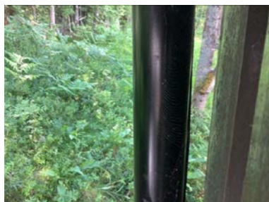
Bildet viser frostsprengt nedløpsrør.
