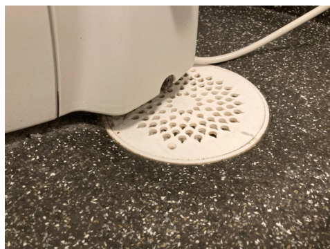
Sluk unde varmtvannsbereder
