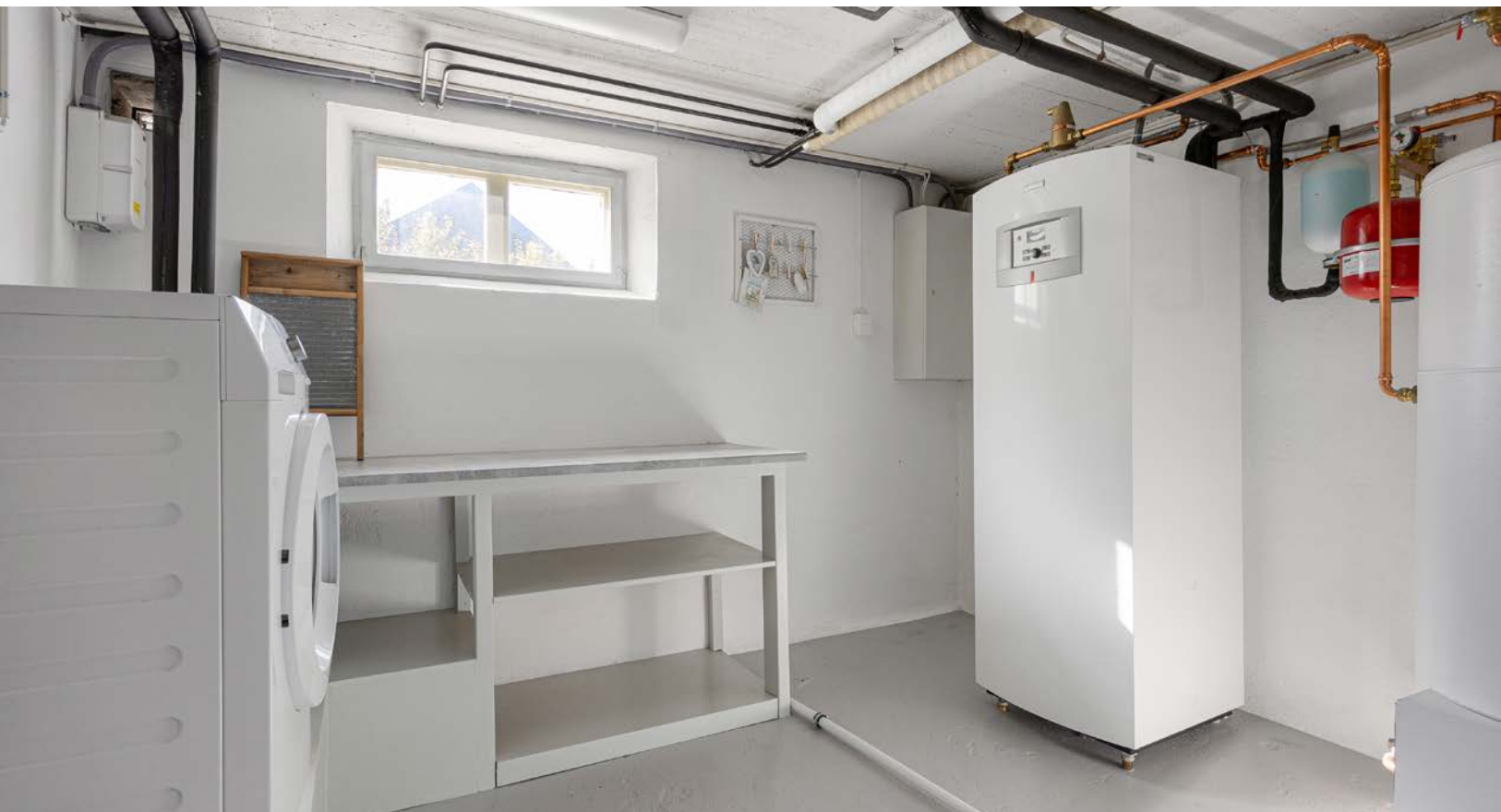
Teknisk rom i kjeller.
