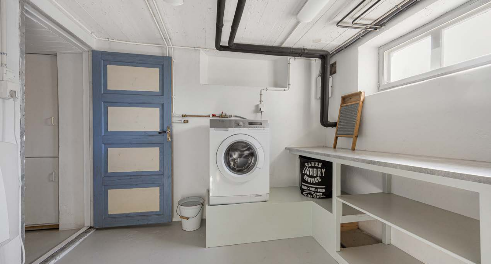
I det tekniske rommet innenfor grovkjøkkenet er det opplegg for vaskemaskin.
