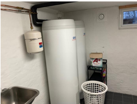
Varmtvannsbereidere i felles vaskerom.
