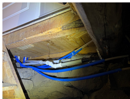
Manglende innfesting av rør
