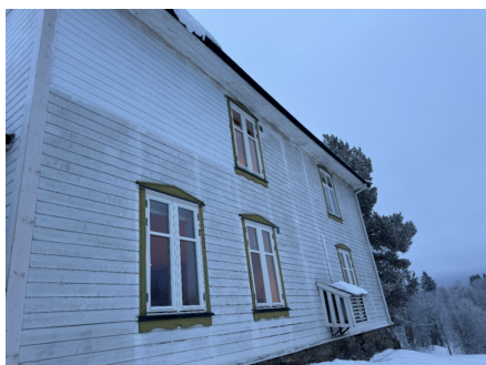
Behov for overflatebehandling av yttervegge
