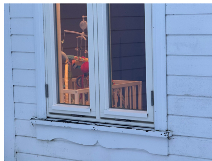
Slitt beslag under vinduer
