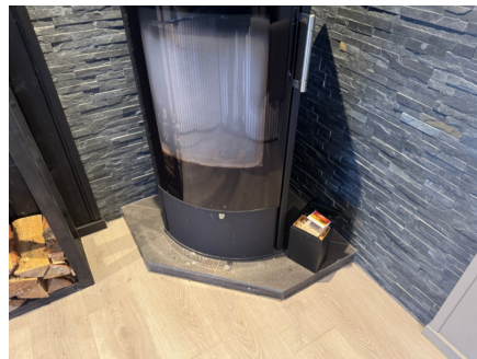
Ikke tilfredsstillende lengde på ubrennbart under vedovn på gulv
