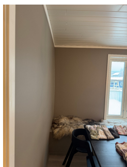
Skjevhet på vegg mellom spisestue og stue
