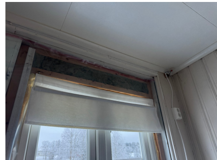
Løse ledninger og åpen kobling
