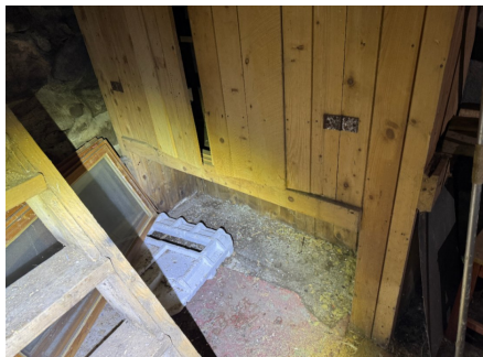
Fuktskader i treverk ned mot gulv
