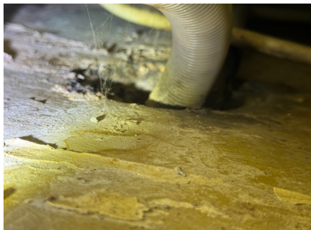
Manglende rengjøring/vedlikehold av sluk
