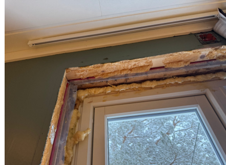
Ikke montert utforinger og lister på vindu
