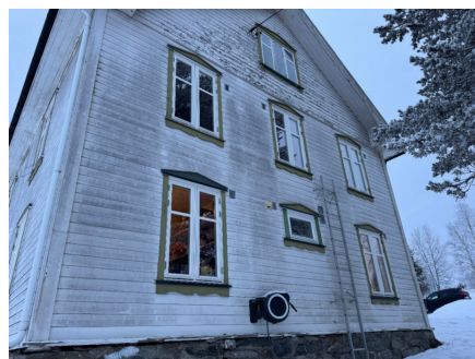
Behov for overflatebehandling av yttervegge
