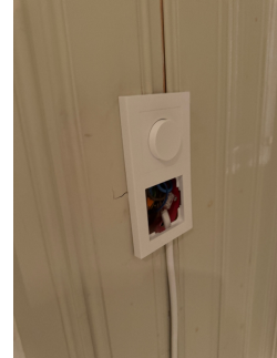
Manglende deksel og dårlig innfestet ledning
