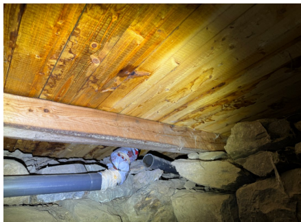
Rør som er frakoblet i kjeller
