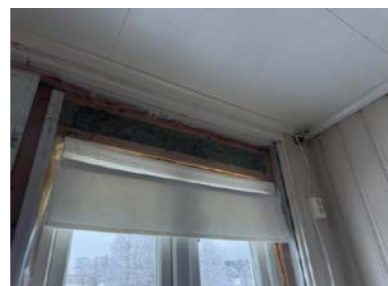
Løse ledninger og åpen kobling
