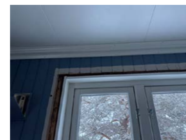
Ikke montert lister
