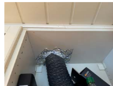
Tapet gjennomføring i skap
