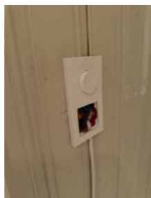
Manglende deksel og dårlig innfestet ledning
