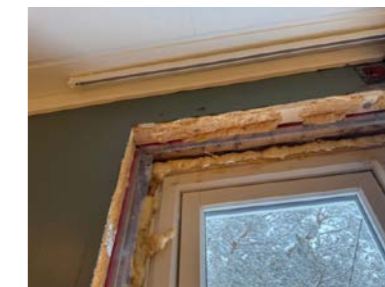
Ikke montert utføring og lister på vindu
