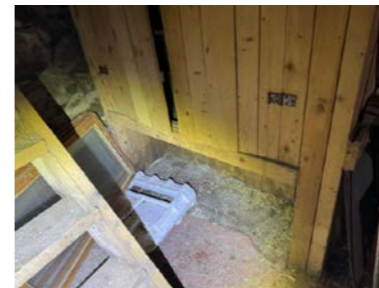
Fuktskader i treverk ned mot gulv
