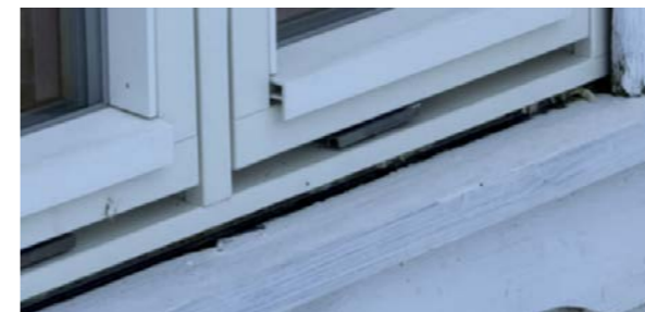
Glippe mellom vindu og beslag under
