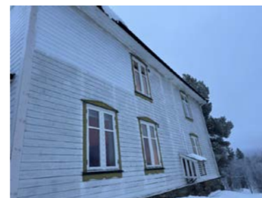
Behov for overflatebehandling av yttervegge
