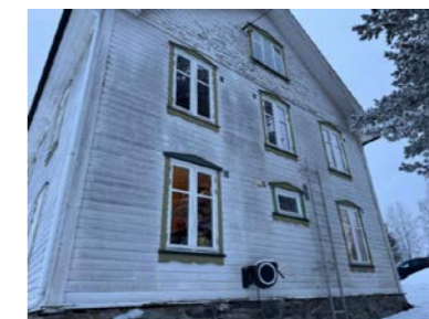
Behov for overflatebehandling av yttervegge
