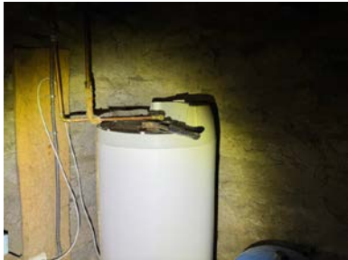
Mye irr på vannrør
