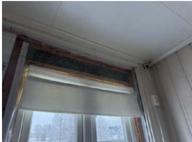
Løse ledninger og åpen kobling
