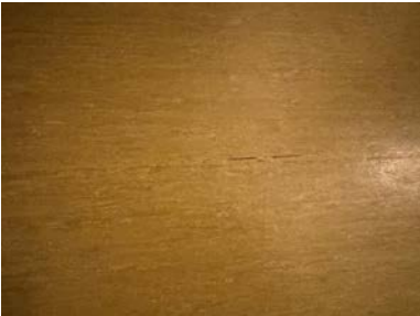
Sprekk i skjøt på gulvbelegg
