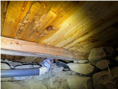
Rør som er frakoblet i kjeller
