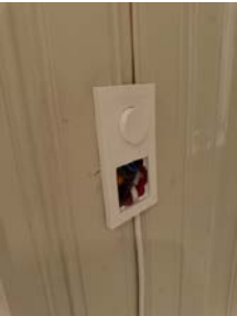
Manglende deksel og dårlig innfestet ledning
