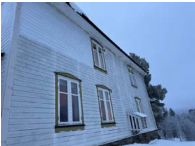
Behov for overflatebehandling av yttervegge
