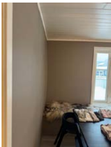
Skjevhet på vegg mellom spisestue og stue
