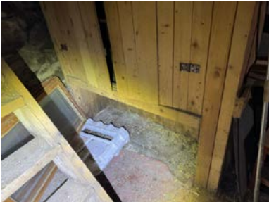
Fuktskader i treverk ned mot gulv
