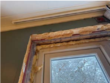
Ikke montert utforinger og lister på vindu
