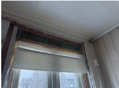
Løse ledninger og åpen kobling
