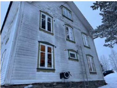
Behov for overflatebehandling av yttervegge
