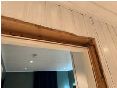
Ikke montert utføringer og lister på dør til soverom
