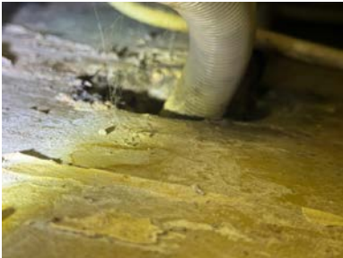
Manglende rengjøring/vedlikehold av sluk
