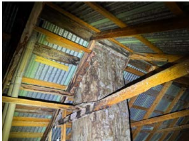
Bekktutslag på pipe
