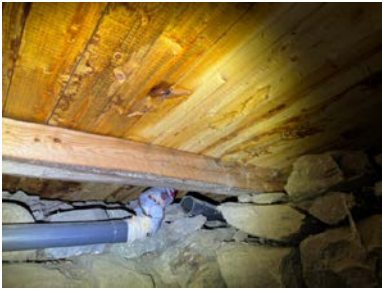
Rør som er frakoblet i kjeller
