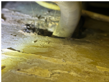
Manglende rengjøring/vedlikehold av sluk
