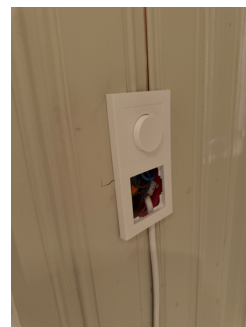
Manglende deksel og dårlig innfestet ledning
