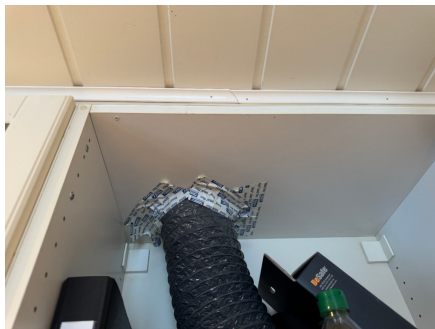
Tapet gjennomføring i skap
