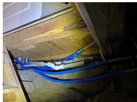
Manglende innfesting av rør
