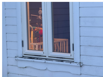
Slitt beslag under vinduer
