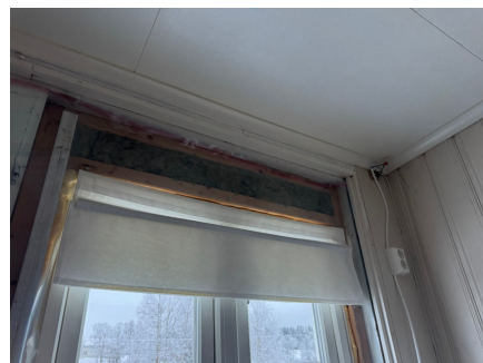
Løse ledninger og åpen kobling
