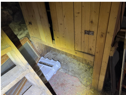
Fuktskader i treverk ned mot gulv
