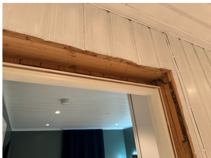
Ikke montert utforinger og lister på dør til soverom
