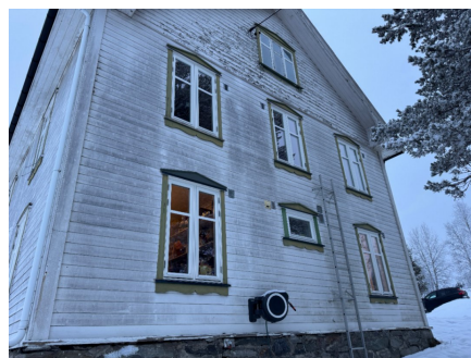
Behov for overflatebehandling av yttervegge
