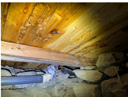
Rør som er frakoblet i kjeller
