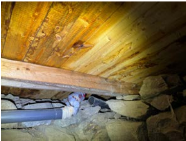
Rør som er frakoblet i kjeller
