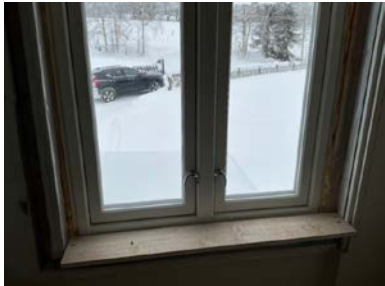
Ikke listet rundt vindu på gang til loft
