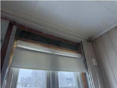
Løse ledninger og åpen kobling
