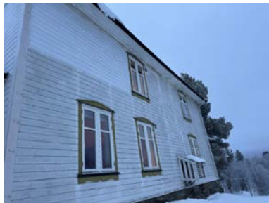
Behov for overflatebehandling av yttervegge
