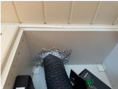
Tapet gjennomføring i skap
