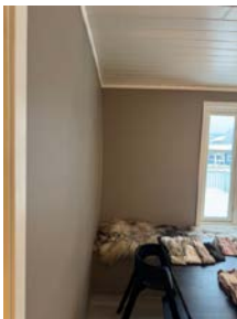
Skjevhet på vegg mellom spisestue og stue
