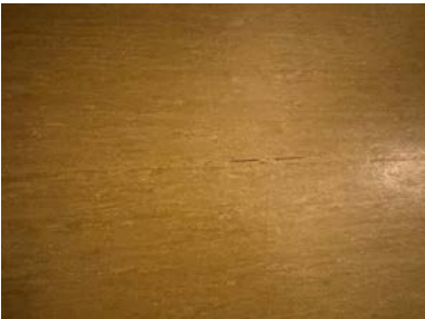
Sprekk i skjøt på gulvbelegg
