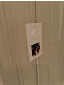
Manglende deksel og dårlig innfestet ledning
