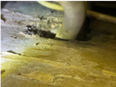
Manglende rengjøring/vedlikehold av sluk
