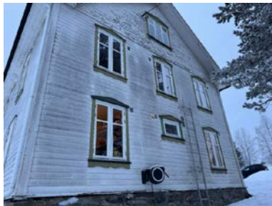
Behov for overflatebehandling av yttervegge
