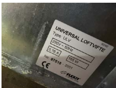
Aggregat fra byggeåret 2001
