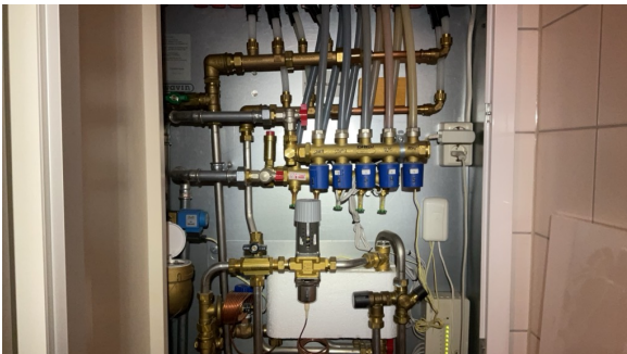
Koblingsskap vannboren varme plassert på bad
