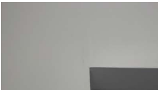
Noe ujevnt underlag på vegg.
