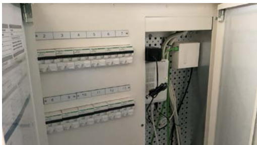
Sikringsskap plassert på bod 1. etasje.
