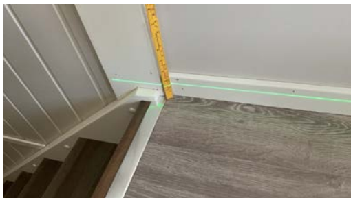
Målt avvik i stue 2. etasje: 12mm.
