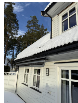
Bilde av takrenne med lekkasje i skjøten og deformasjon
