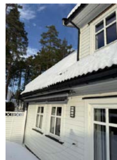
Bilde av takrenne med lekkasje i skjøten og deformasjon
